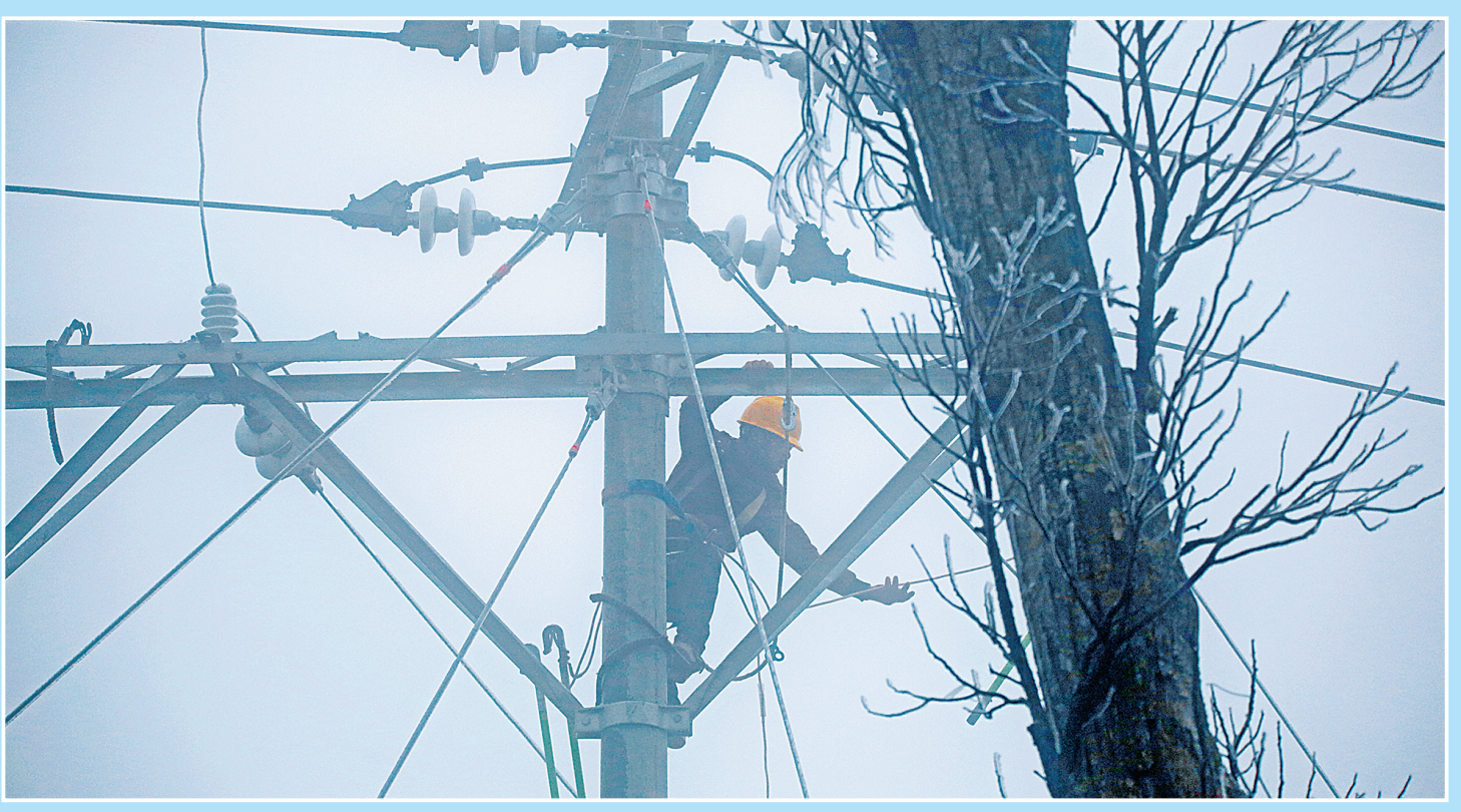
12月16日下午,桂东县湘江镇坪水村槽里坳,党员抢修突击队正在小雪纷飞中为断电线路搭头。连日的低温极端天气,给山城桂东的供电造成较大困难,跨过高山隘口的电线因冰挂连续发生断线,同时因雾凇越积越多致树木倒塌压断电线也时有发生。为确保生产和生活用电,国网桂东电力公司成立了20余支以党员为首的抢修突击队,哪里有故障就在第一时间出现在哪里,并对特殊隘口每天进行巡逻,确保供电稳定。(邓仁湘 摄)
